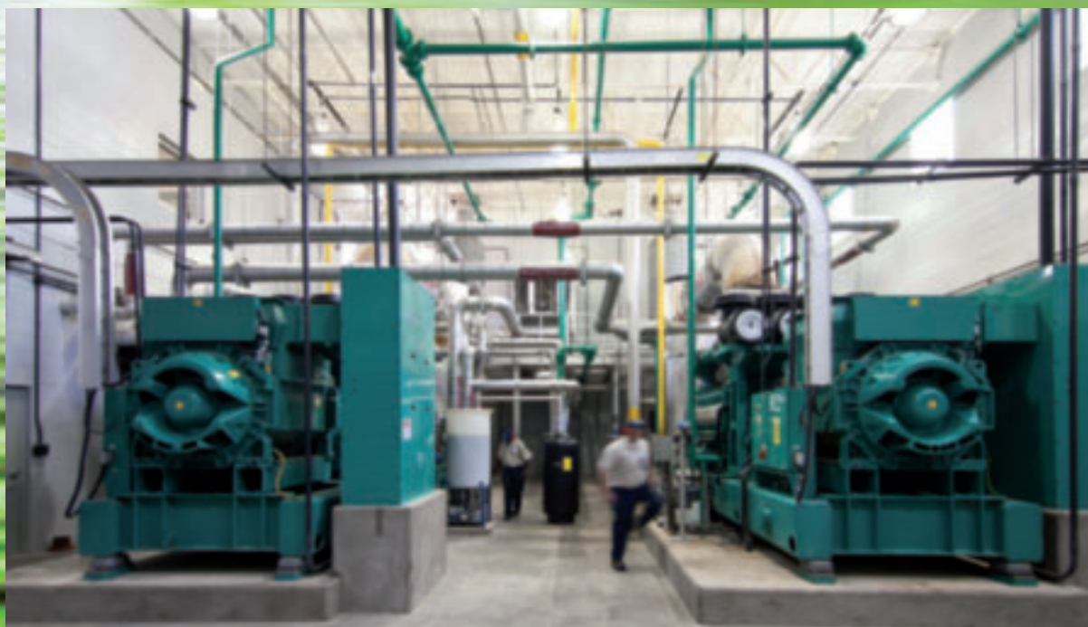
Две 1,75 МВт газовые электростанции в городе Колумбус на водопроводных сооружениях.
