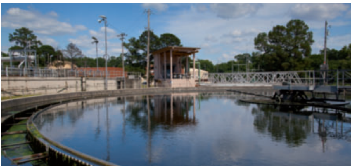
Водопровод в г. Колумбус (шт. Джорджия, США) где установили две электростанции Cummins Power Generation на обедненной смеси газа.
